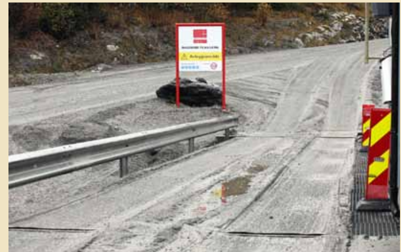
Bilvekker, som denne fra et pukkverk på Romerike, er gjenstand for røff behandling. En workshop med bransjen i 2024 har vært et viktig tiltak for å nå ut med informasjon og veiledning.
