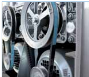
Reimene i pumpa er utsatt for slitasje.
